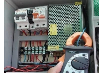
(ข) ชุดควบคุมระบบจ่ายไฟฟ้า
